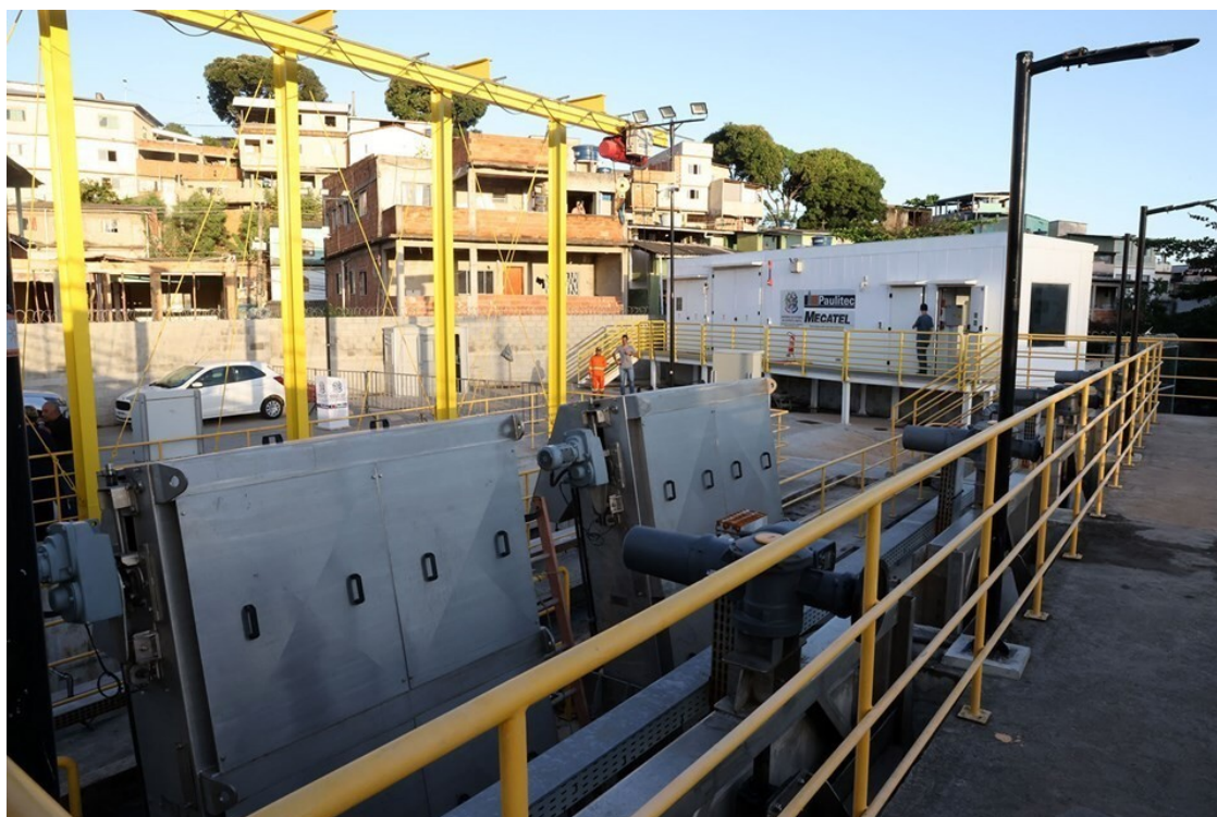
Foto 12: Estação de Bombeamento de Águas Pluviais Aribiri. Crédito: Comunicação/SEDURB.
