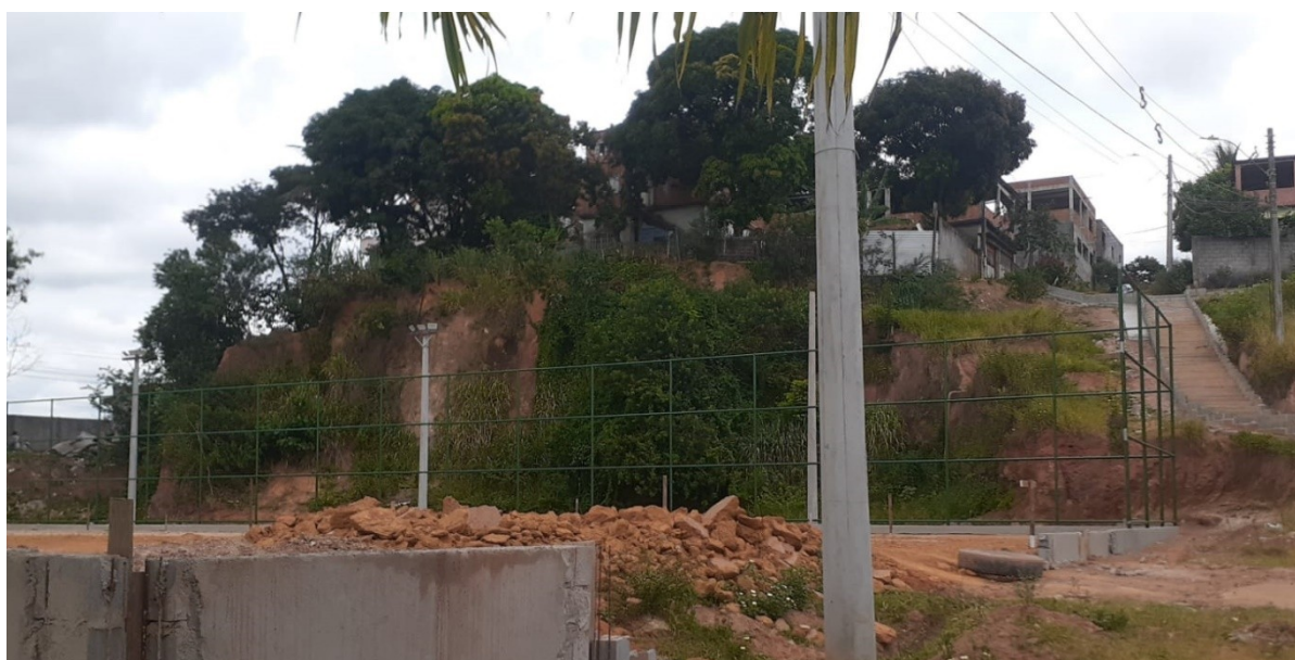
Figura 178– Vista a partir da Rua C na base da encosta. Detalhe para a amplitude e inclinação elevada dos taludes.
