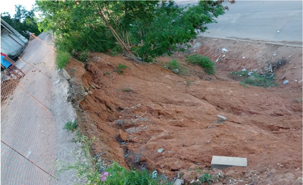
Figura 105– Vista a partir da Rua Ex-combatente. Detalhe para a condição atual da via após a ocorrência de deslizamentos.
