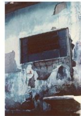
Figura 29 – Gradativa destruição da parede pelos sucessivos ciclos de umedecimento e secagem do material constituído por solo, favorecidos cada vez mais pelos danos no revestimento
