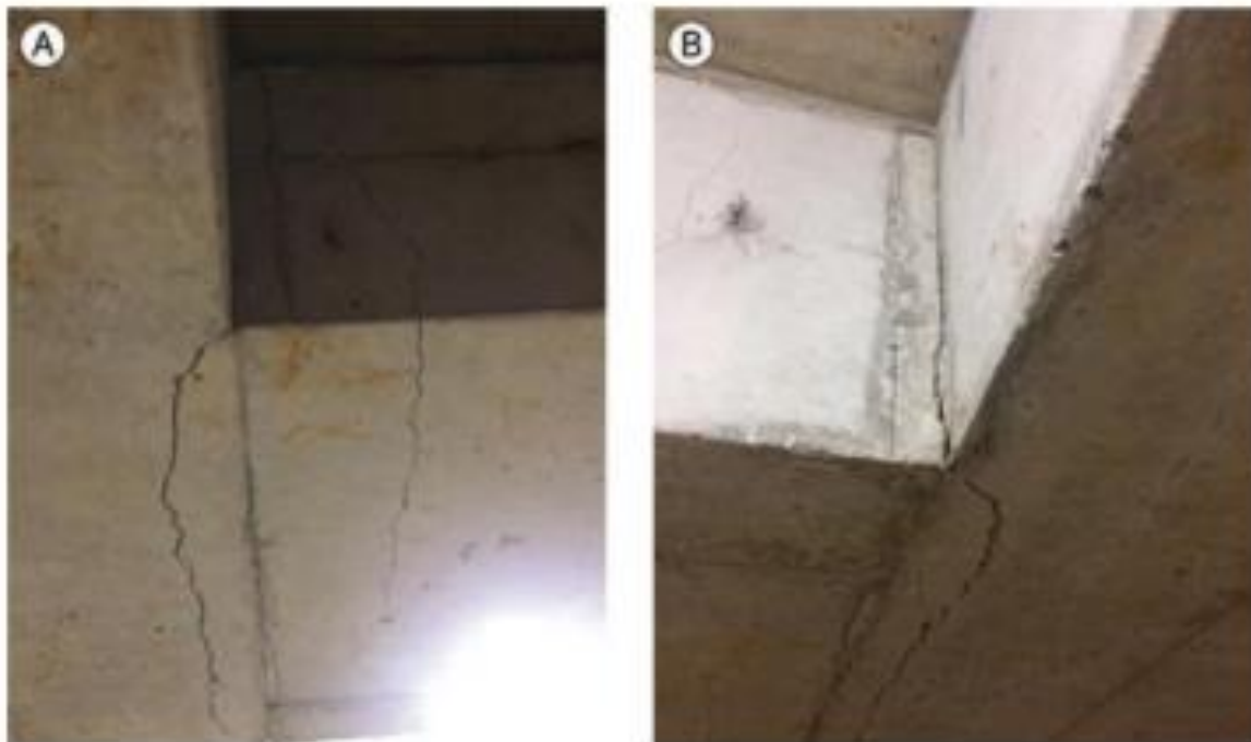
Figura 37 – Fissuras importantes nos encontros de (A) viga com pilar e (B) viga com viga, decorrentes de projeto inadequado de estribos ou armaduras de suspensão, falhas de montagem das armaduras e/ou carregamento precoce da estrutura
