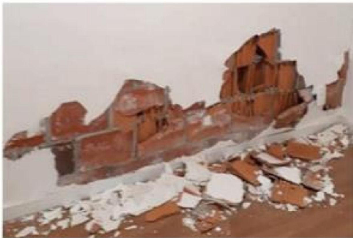
Figura 49 – Alvenaria de blocos cerâmicos estruturais solicitada à compressão: a deformação transversal da argamassa de assentamento provoca a ruptura de nervuras internas e a expulsão dos “tampos” de alguns blocos
