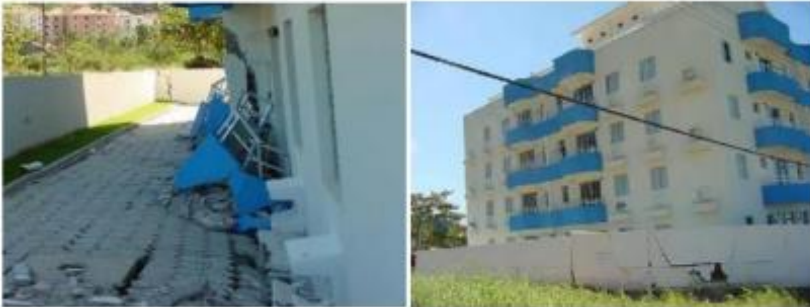
Figura 96 - Edificação no litoral norte de São Paulo, com importante desaprumo causado pelo adensamento de camada de argila marinha, gerando tensões horizontais que provocaram a ruptura de estacas – efeito Tschebotarioff
