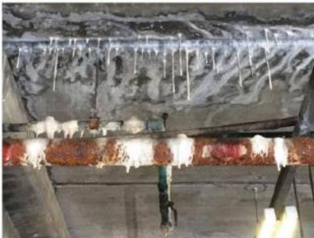
Figura 103 - Fissura de retração no capeamento da laje pré-fabricada facilita infiltração de água, lixiviação da cal e formação de carbonato de cálcio, sendo que o sal está originando a corrosão da tubulação de incêndio (caso típico onde uma patologia provoca outra patologia)
