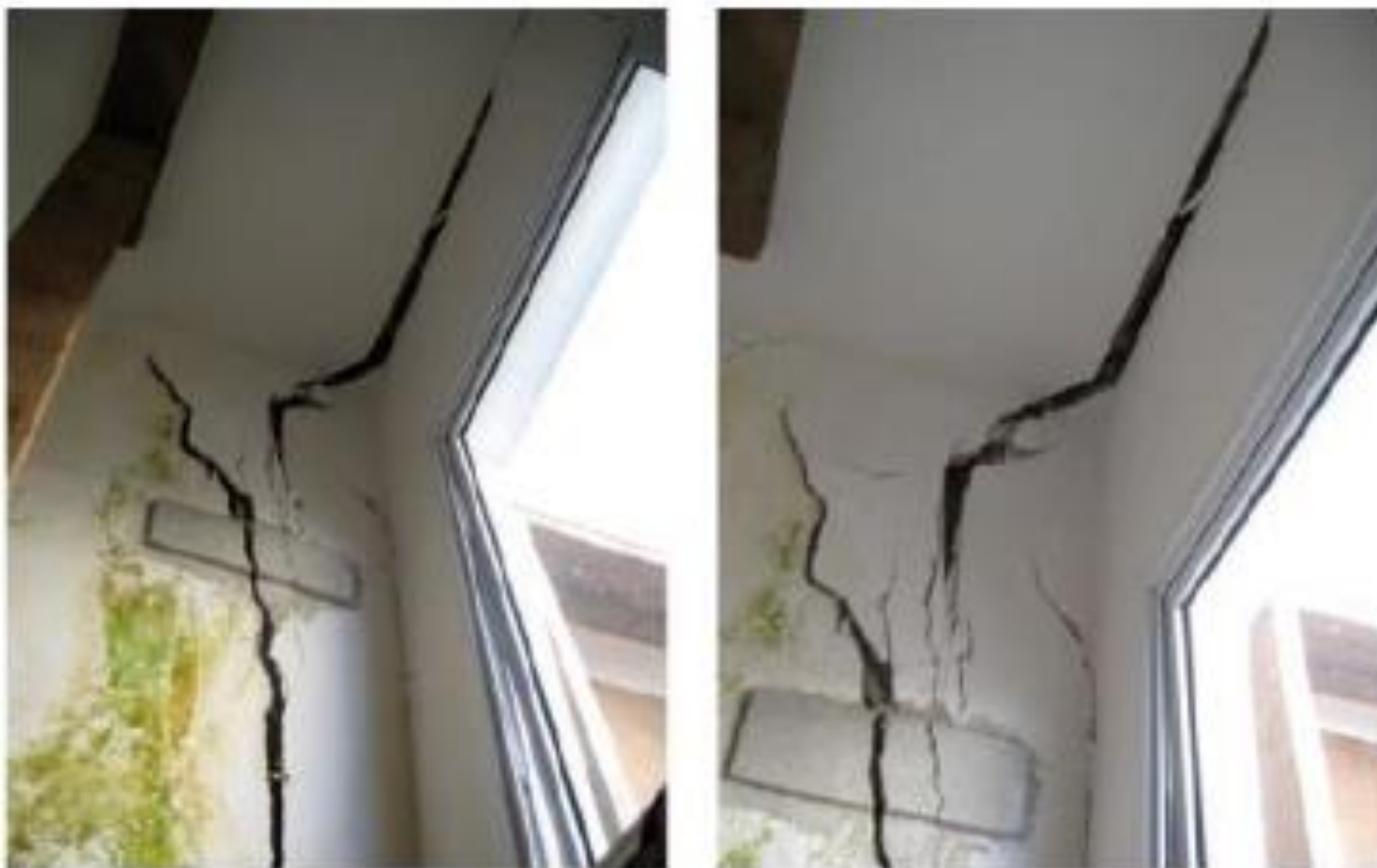
Figura 95 - Fissura com abertura bastante pronunciada em sobrado com necessidade de reforço das fundações e da própria estrutura.
