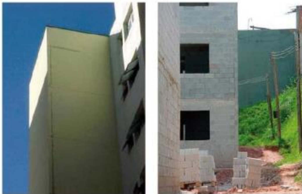
Figura 9 – Destacamentos entre alvenarias de fachada – alvenaria estrutural sem juntas de amarração entre as paredes
