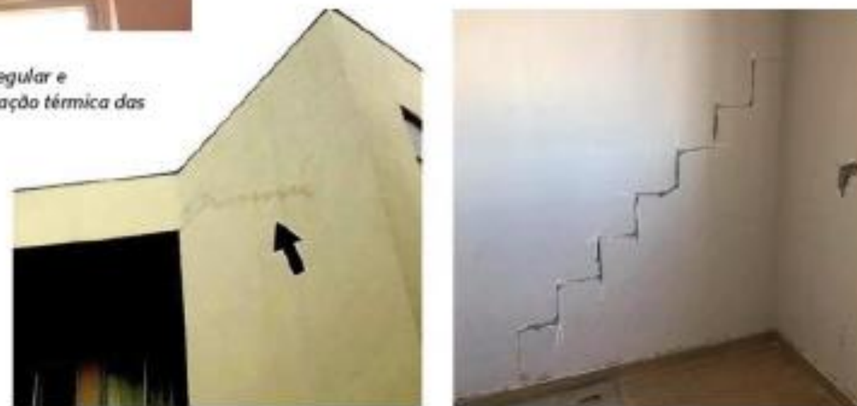
Figura 6 - Trincas de cisalhamento provocadas por expansão térmica da laje de cobertura, com destacamentos entre os componentes de alvenaria
