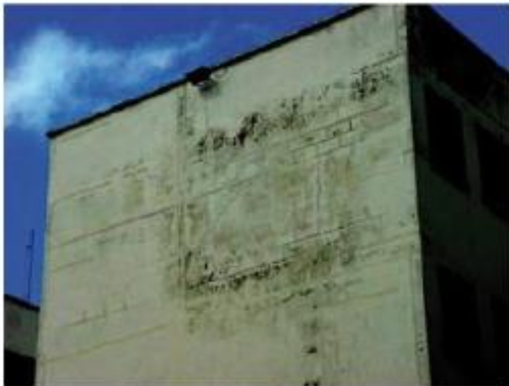
Figura 106 – Destacamentos entre blocos de concreto e argamassa de assentamento, e também fissuras de retração na alvenaria como um todo, provocando infiltrações de água e formação de bolor.
