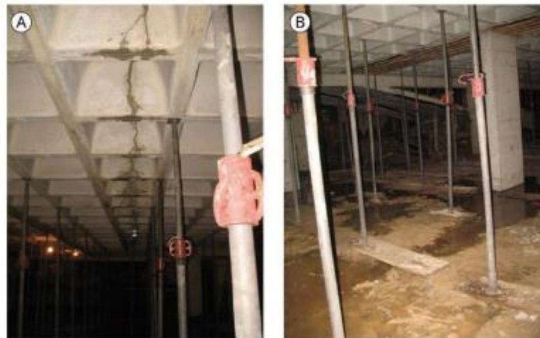
Figura 41 – Intensa fissuração de laje nervurada pela ocorrência de recalque de escoras apoiadas sobre o solo (subsolo recebeu acesso de água de chuva)
