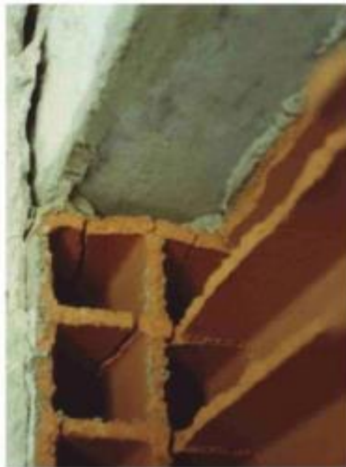
Figura 67 – Ruptura característica de bloco cerâmico com furos horizontais sob deformação imposta: observar na foto o encurtamento das paredes externas do bloco e a ruptura das nervuras horizontais internas
