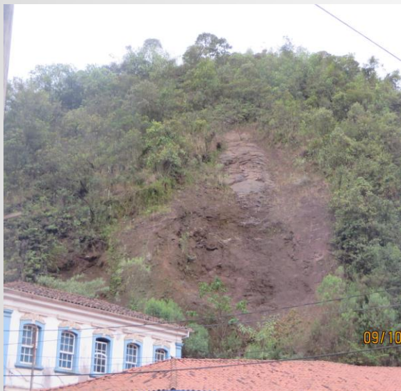
Deslizamento Planar - Ouro Preto - MG
