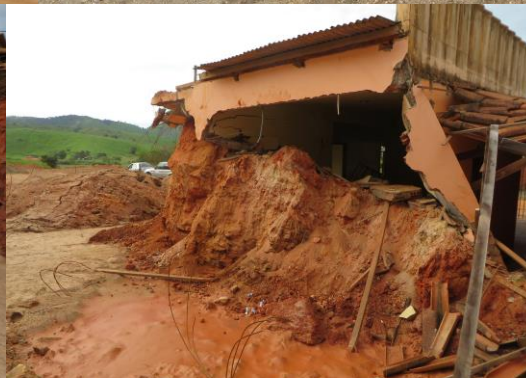
Deslizamento rotacional Itanhomi – MG Abril de 2015
