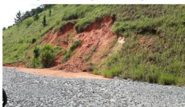
Imagem 4: Deslizamento em talude de corte às margens da duplicação da Rodovia BR 285.
