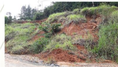
Imagem 40: Deslizamento às margens da Estrada Serenata.
