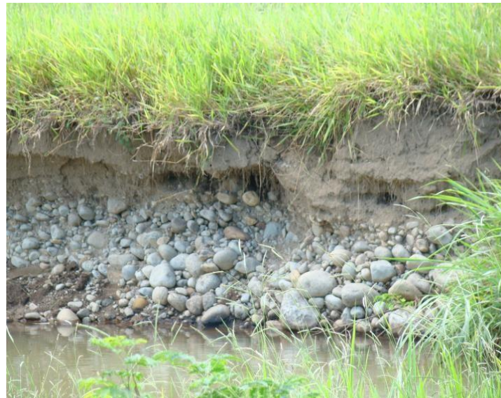
Corrida de massas. Depósito de seixos indicativo de corridas de detritos pretéritas. Local: Riacho sem nome em Queluz- SP Créditos: Pedro Pfaltzgraff
