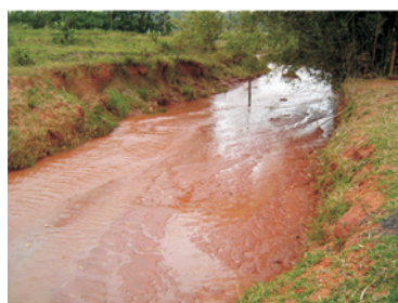
Figura 5.7 – Taludes marginais sujeitos a erosão.
