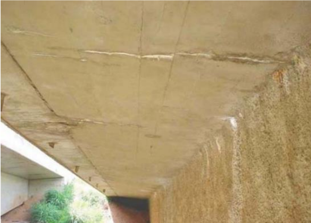
CARBONATAÇÃO DO CONCRETO
