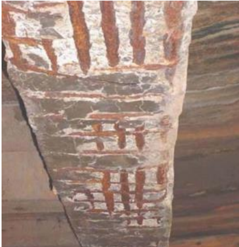
CORROSÃO DA ARMADURA
