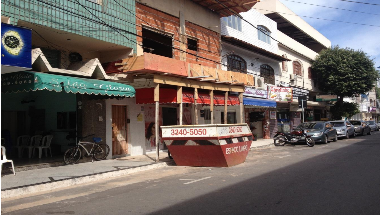
Escoramento inadequado de marquise Junho/2013 - Vila Velha/ES
