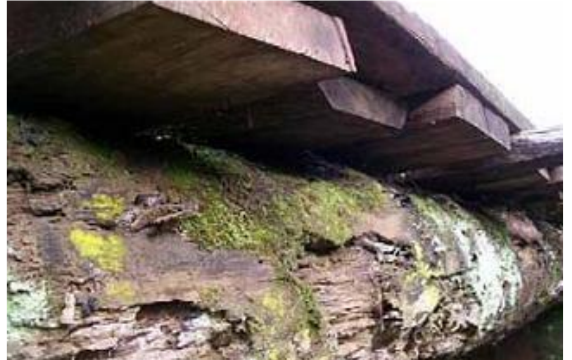
VIGA EM ESTÁGIO DE APODRECIMENTO
