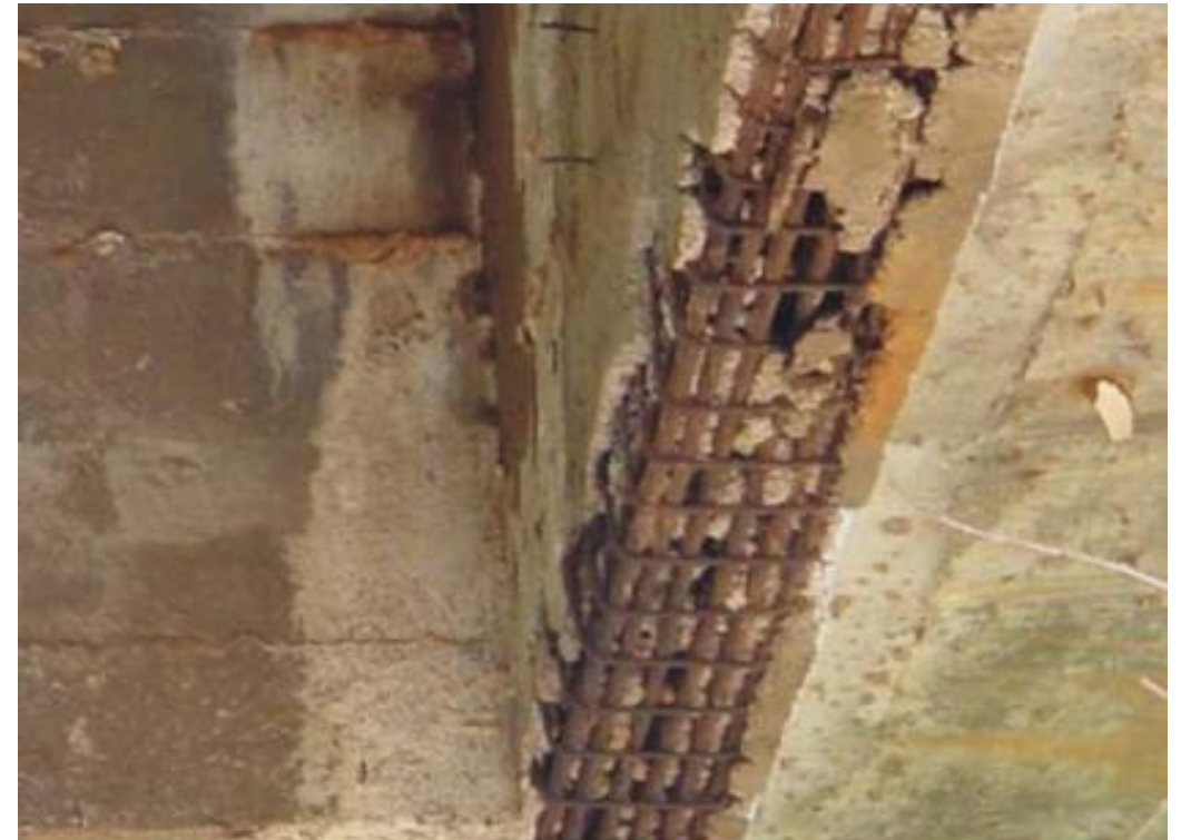
VAZIOS DE CONCRETAGEM
