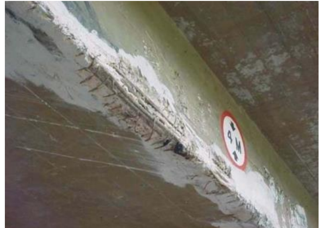
AUSÊNCIA DE COBRIMENTO E ESTRIBOS ROMPIDOS
