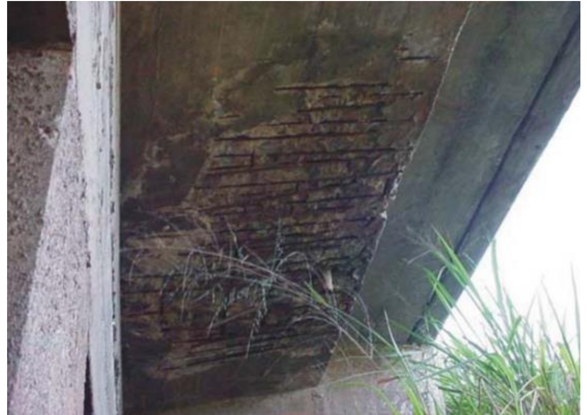
AUSÊNCIA DE PINGADEIRAS
