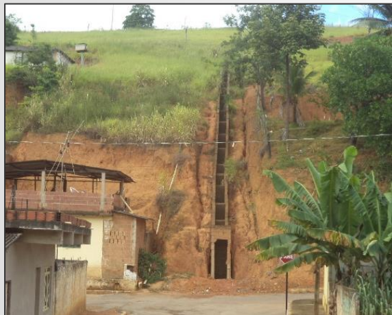
Escada hidráulica com erosão lateral
