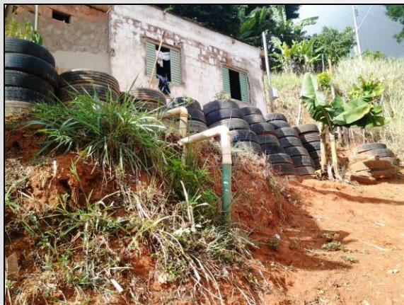
Contenção de pneus sem amarração e sem intercalação de carreiras - instável
