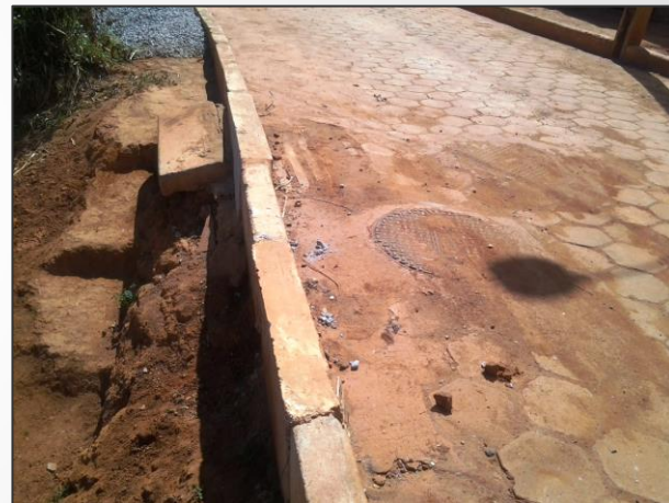
Boca de lobo obliterada
