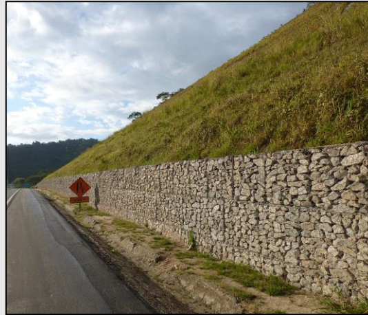
Muro Gabião Créditos: ENG Consultoria e Projetos
