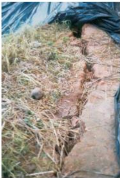
FENDA de RUPTURA UR-10, Recife
