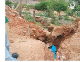
Erosão, proveniente do lançamento de aterro e da falta de drenagem na encosta
