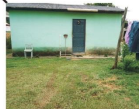
Marca do nível atingido pelas águas
