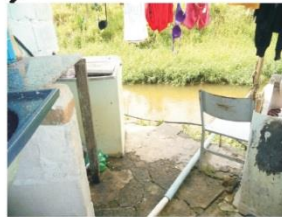
Erosão da margem, danificando estrutura da residência (a casa balança)
