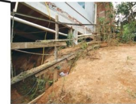
Residência com os alicerces comprometidos
