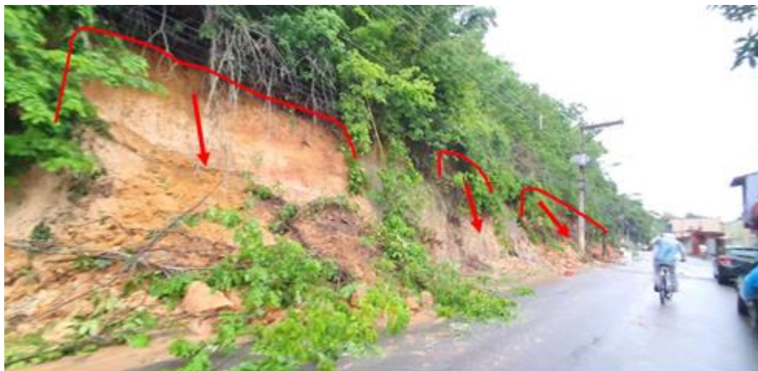
Ponto 03 – Conjunto de movimentos de massa gravitacionais com atingimento da margem da Avenida Cricaré
