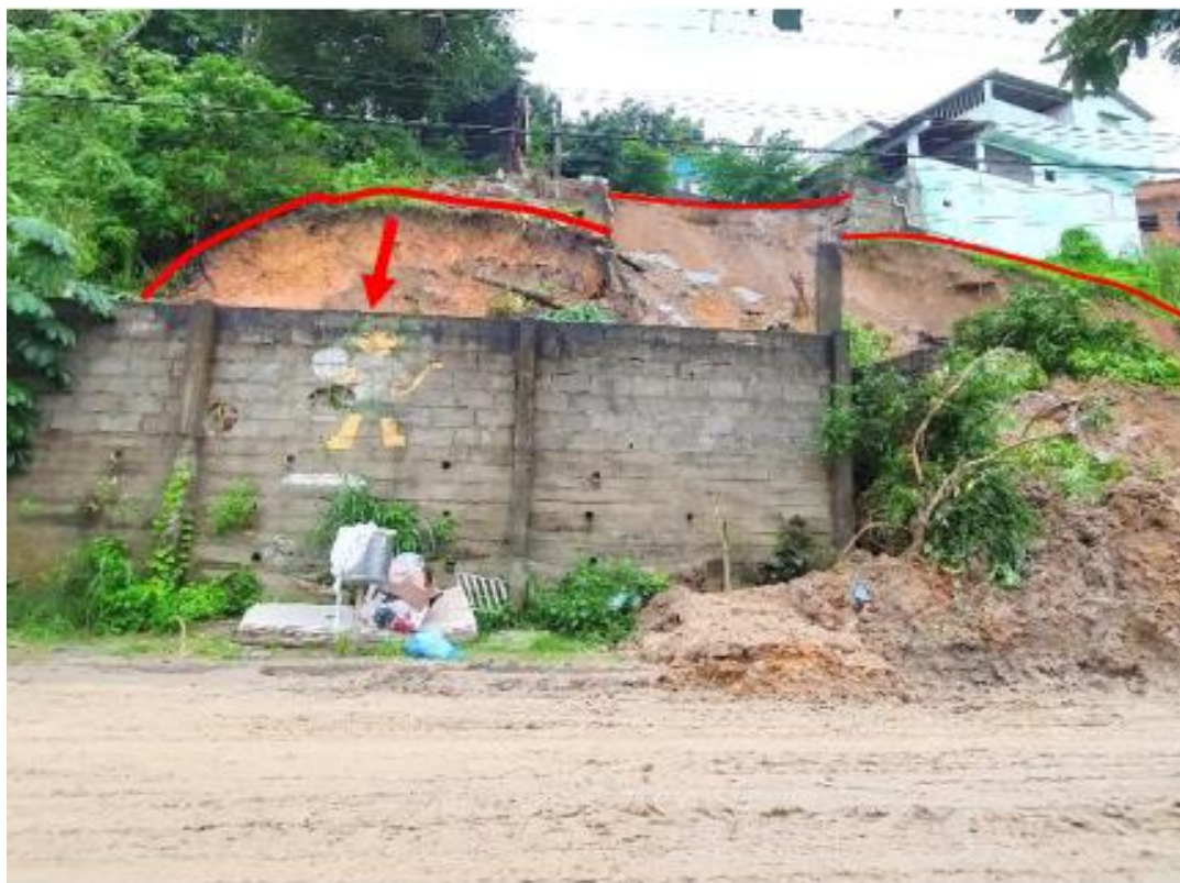
Ponto 05 – Cicatriz de escorregamento atrás do muro da propriedade
