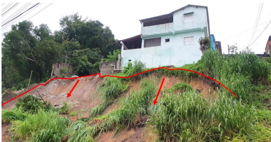
Ponto 05 – Vista em detalhe do escorregamento na base do imóvel, com risco iminente de novas movimentações e avarias na estrutura
