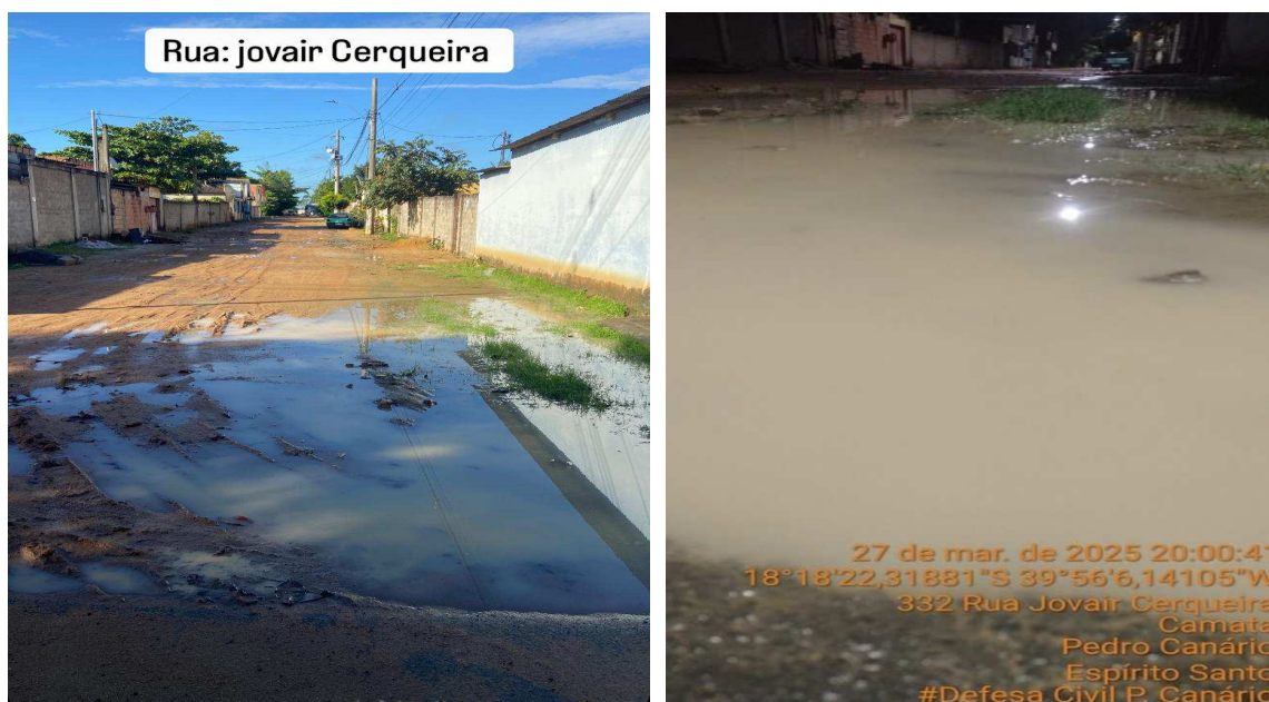
Foto 26 e 27: Rua sem drenagem e pavimentação com problemas de alagamentos em alguns trechos. Coord.: 18° 18' 22,31" S 39° 56' 6,14" W
