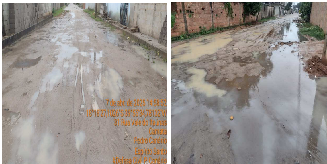
Foto 22 e 23: Trechos sem drenagem e pavimentação suscetíveis a alagamentos na rua Vale do Itaúnas e rua Principal. Fotos das chuvas abril/2025. Coord. 18°18'27,1026" S 39°56'34,78132"W
