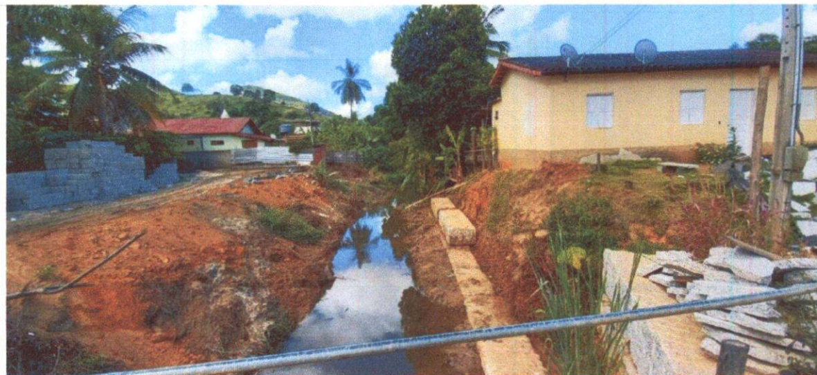
Imagem Córrego Cedrolândia, com potencial para causa de enchente/inundação.
