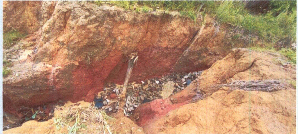
Imagem com detalhe do erosão em talude.
