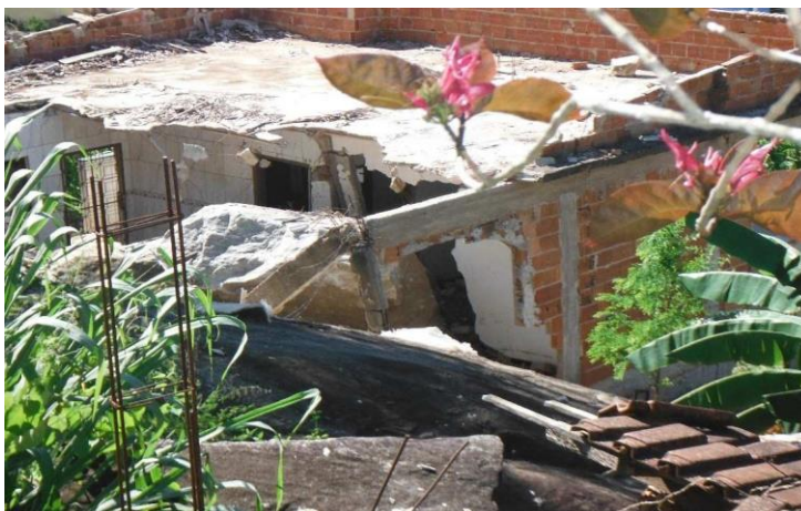
Fotos: Deslizamento, bairro: Mangueira - Dezembro 2016.
