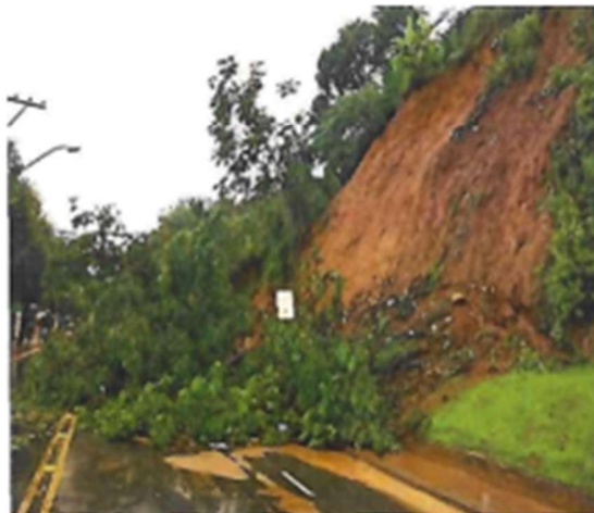
Foto 19: Queda de Barreira na Av. Getulio Vargas— Centro
