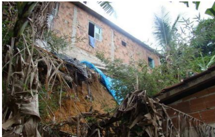
Foto 05: Área de risco com talude de corte vertical (-90°), com risco R4. Fonte: CPRM 2012
