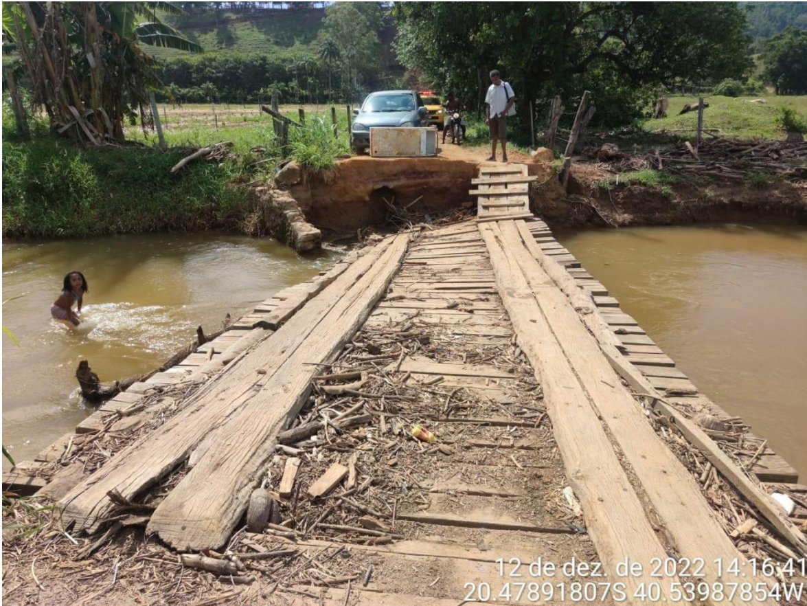
Foto 11: Desmoronamento de ponte de madeira, utilizada em área rural de Guarapari. Fonte: COMPDEC
