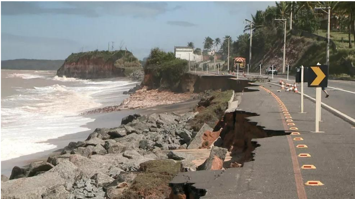
Foto 18: Situação da erosão em 2021-Rodovia ES-060. Fonte: Gazeta ES
