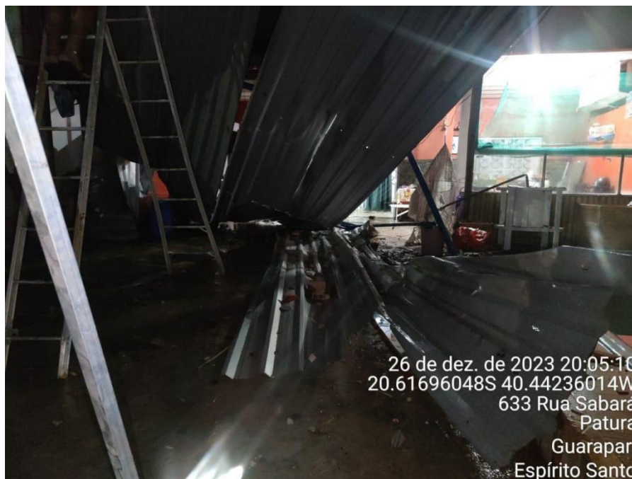
Foto 13: Estrutura de cobertura avariada, durante período de evento adverso. Fonte: COMPDEC
