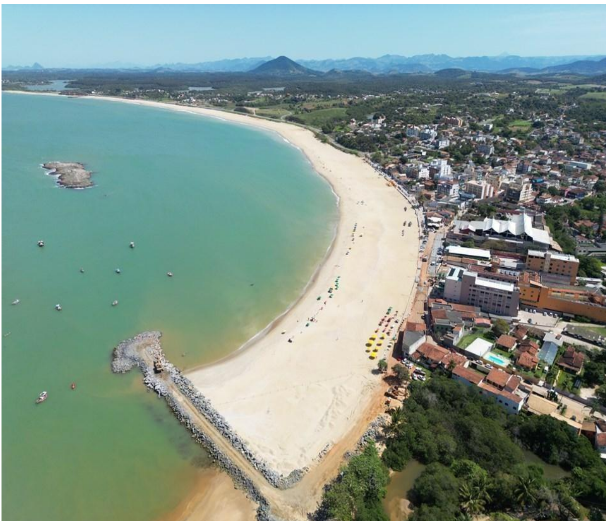
Foto 19: Vista aérea da obra do Governo do ES em Meaípe-Guarapari. Fonte: SETUR/ES
