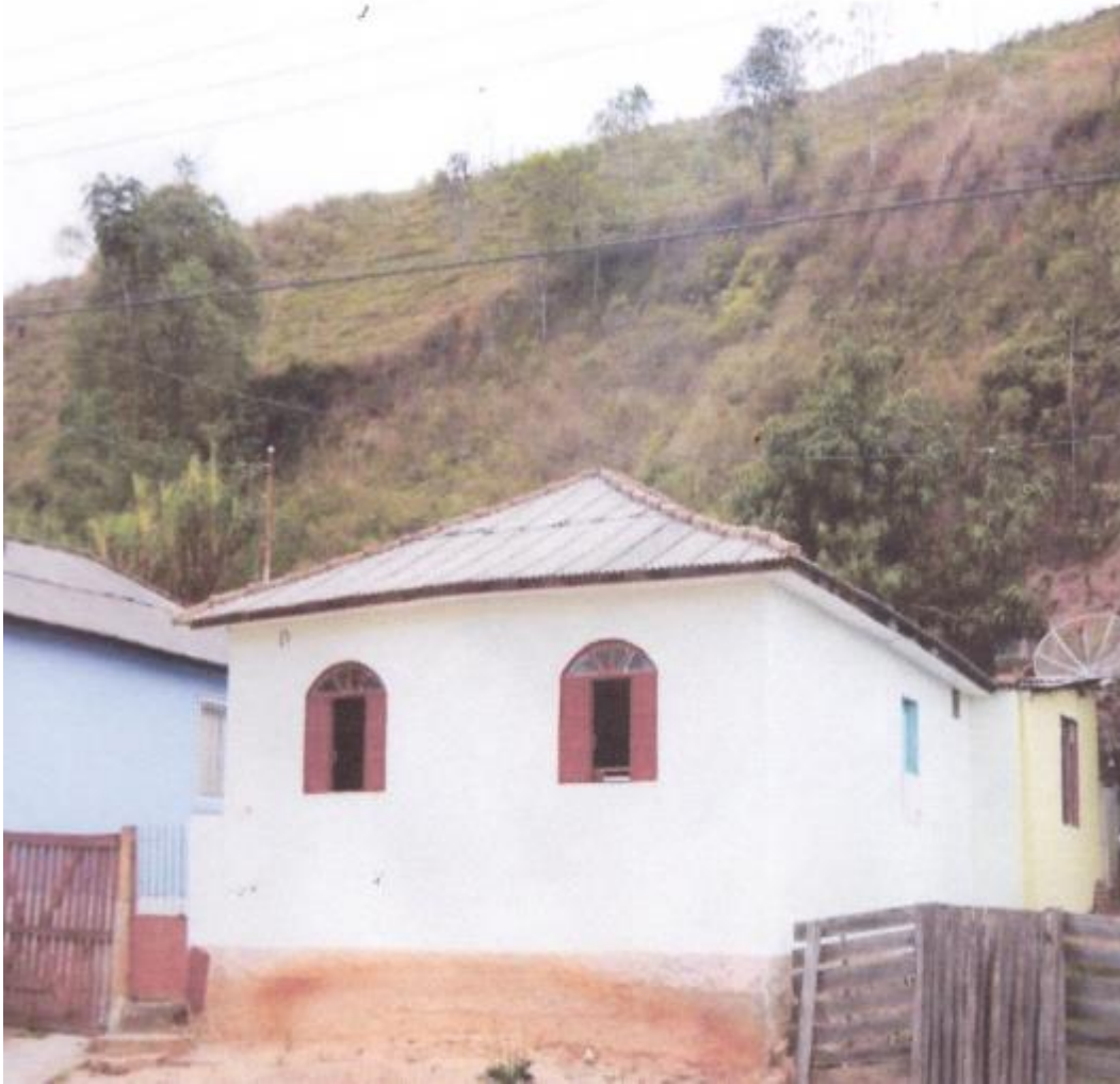
Foto 1: Um dos imóveis atingidos por deslizamentos em 1989.
