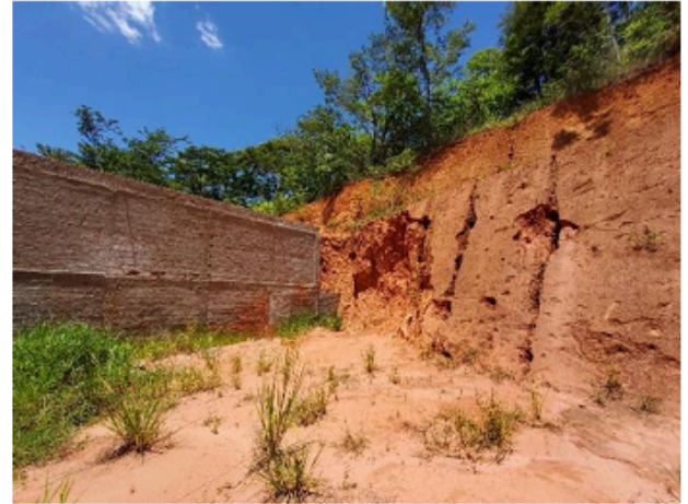
Figura 05 – Sulcos e cicatrizes de pequenos deslizamentos evidenciam a alta erodibilidade do substrato sedimentar.
