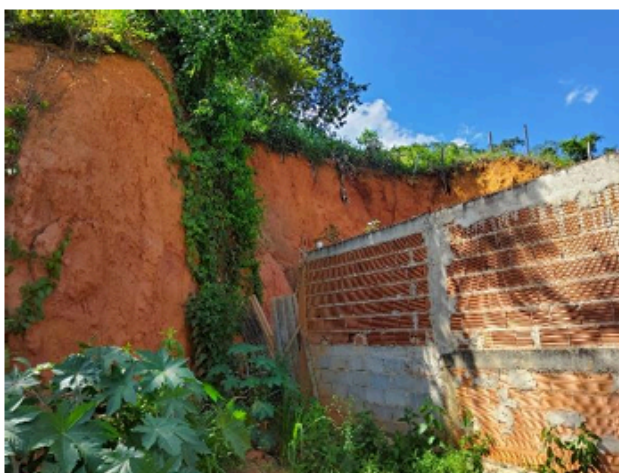
Figura 02 - Proximidade do imóvel junto ao talude.
