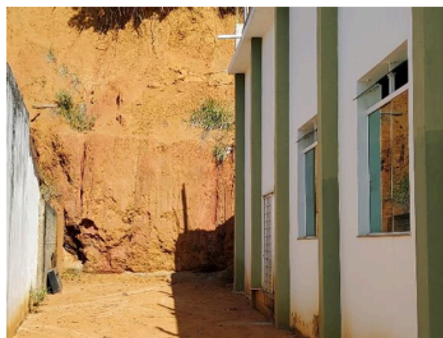
Figura 03 - Imóvel junto a talude de corte de alta.
