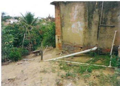
Figura 7: Lançamento desordenado de esgoto em encosta de declividade média.
