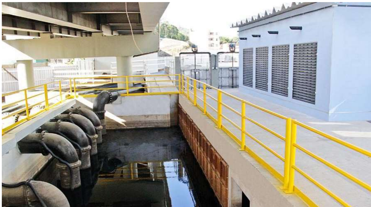
Foto 5: Estação de Bombeamento de Águas Pluviais do Canal da Costa. Crédito: Comunicação/PMVV.
