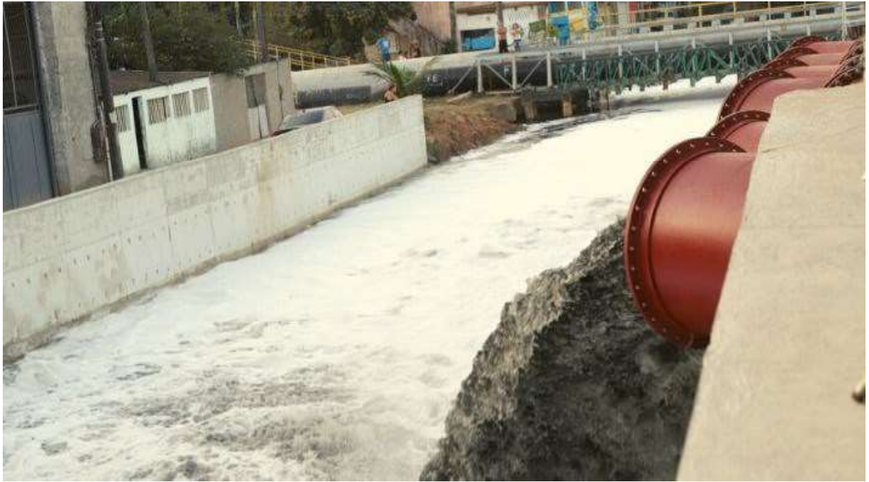
Foto 9: Estação de Bombeamento de Águas Pluviais Cobilândia. Crédito: Comunicação/PMVV.
