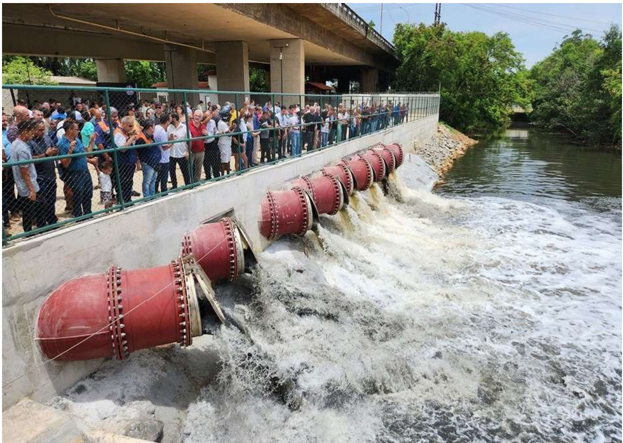
Foto 10: Estação de Bombeamento de Águas Pluviais Marinho. Crédito: Comunicação/SEDURB.
