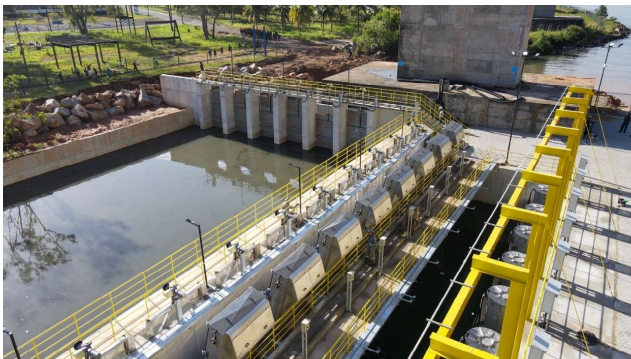
Foto 8: Estação de Bombeamento de Águas Pluviais Foz do Costa. Crédito: Comunicação/SEDURB.
