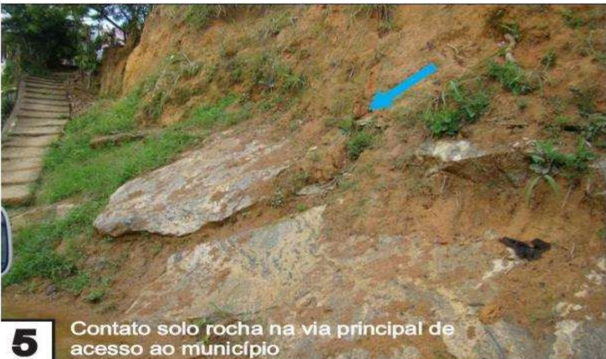
Casas para serem removidas- risco de deslizamento
