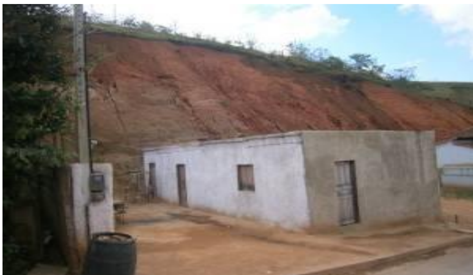
Foto 1 - Moradia junto à base de talude de corte na base da encosta. Processos erosivos em evolução.
