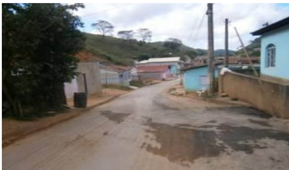
Foto 03 - Via do setor com deficiência no sistema de drenagem pluvial.
