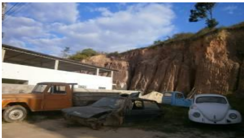
Foto 07: Pontos comerciais muito próximos à base de talude de corte com processos erosivos em evolução.
