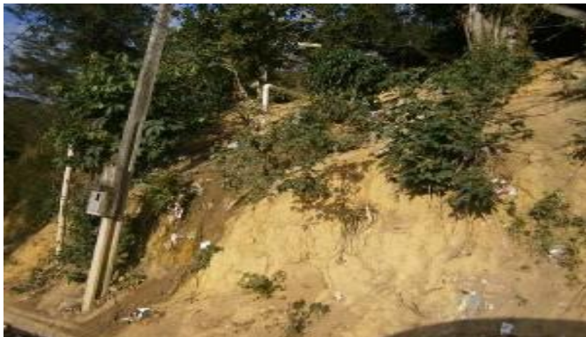
Foto 06: Lançamento de lixo e de água servida sobre face de talude com solo exposto.
