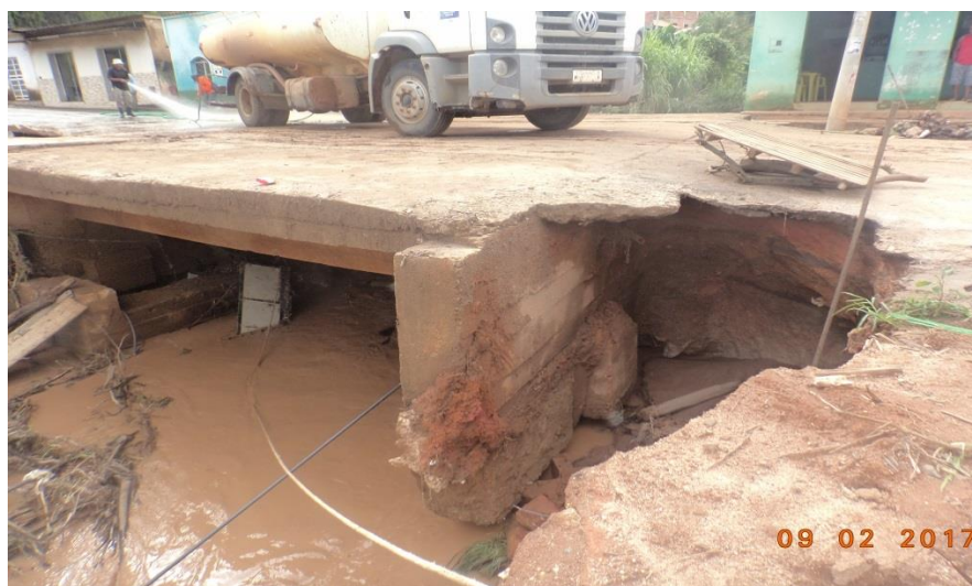
Foto 05: Abertura de Cratera no meio da rua.
