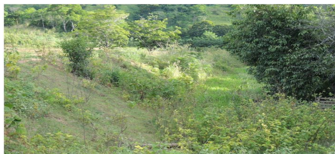
4. Vegetação excessiva no talude de jusante.
