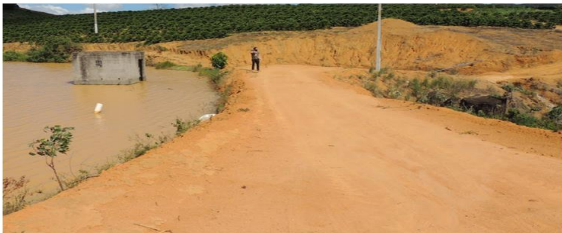
3. Falta de proteção ou escoamento de águas pluviais.
