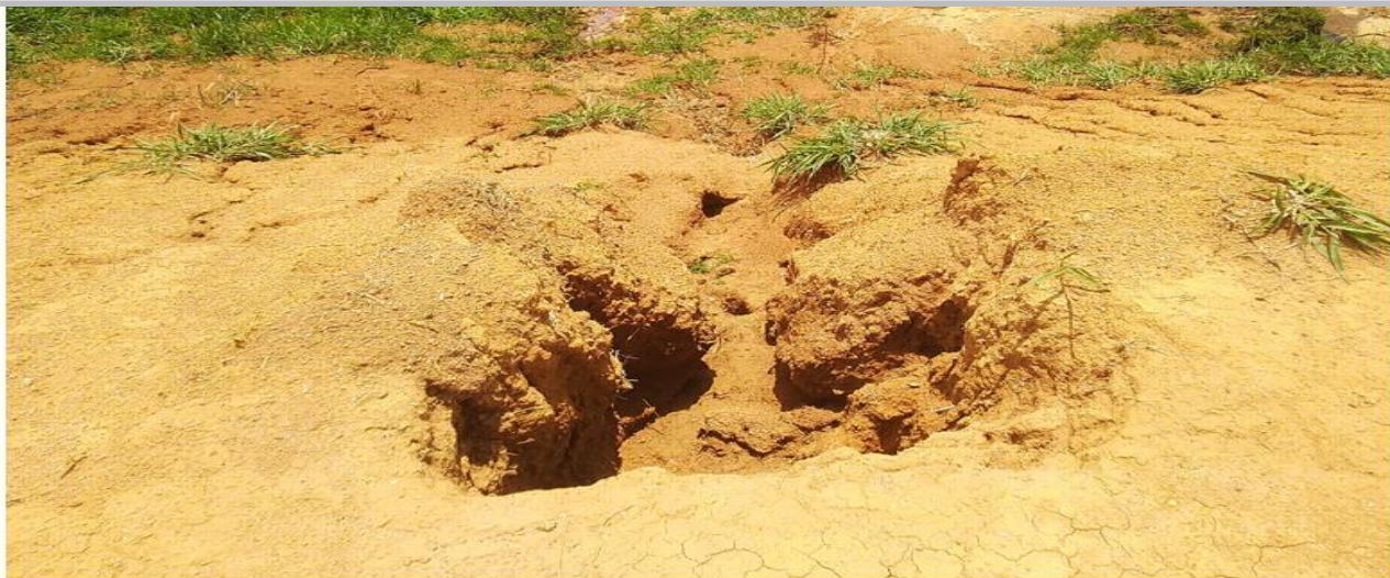
1. Erosão no talude de jusante.
