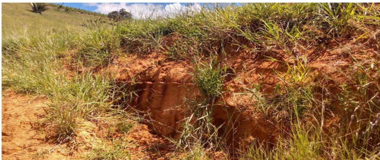
3. Trinca no talude de jusante.
