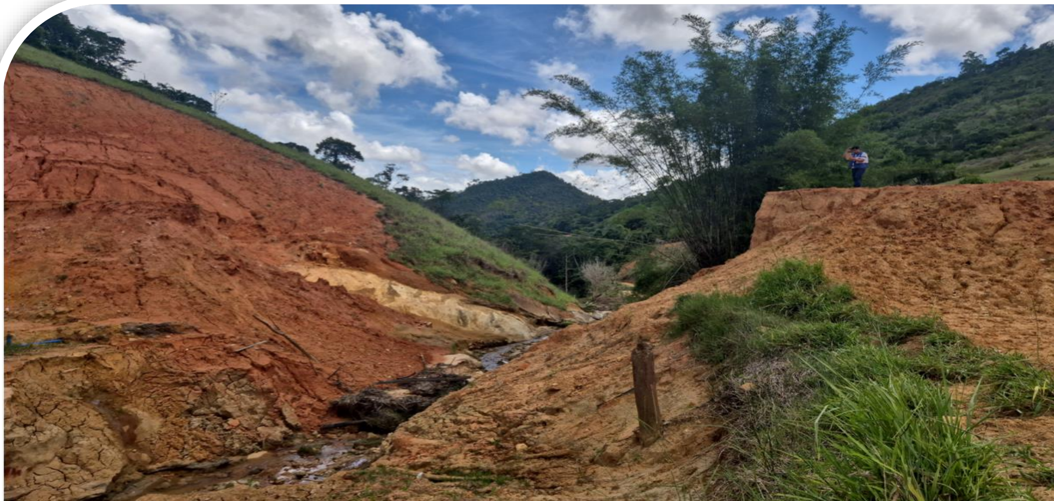
3. Rompimento por galgamento, falta de vertedor, barragem de terra sob base de rocha
