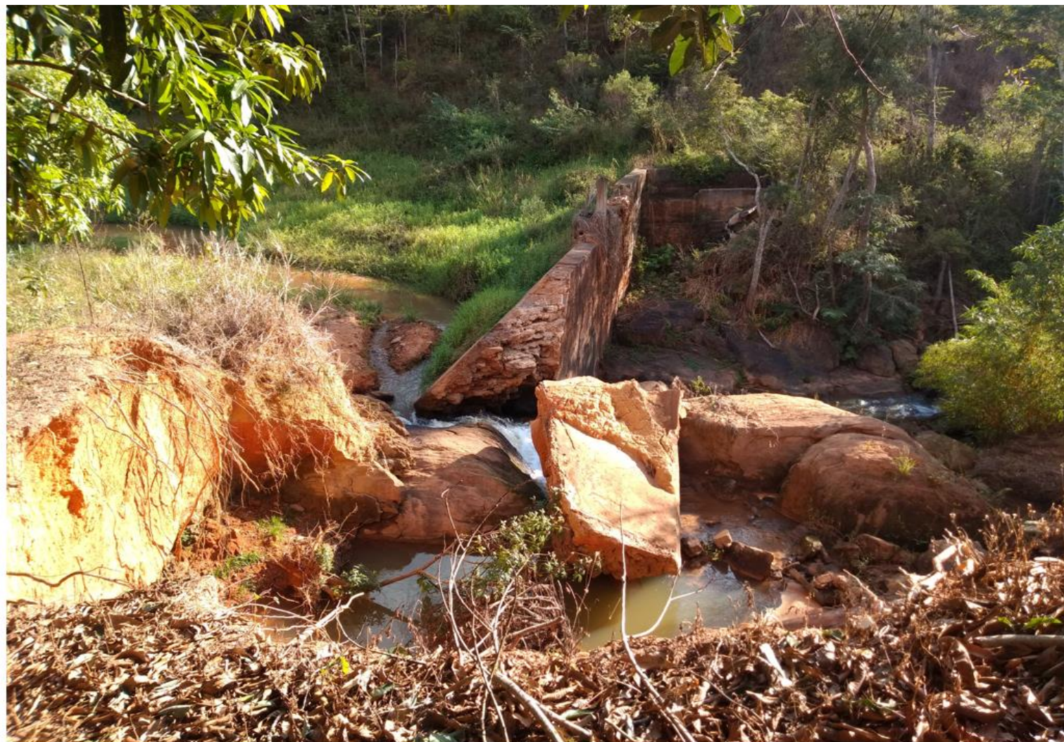
2. Rompimento por tombamento de árvore na ombreira.
