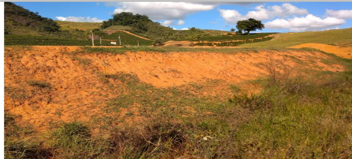
2. Talude de jusante sem proteção.
