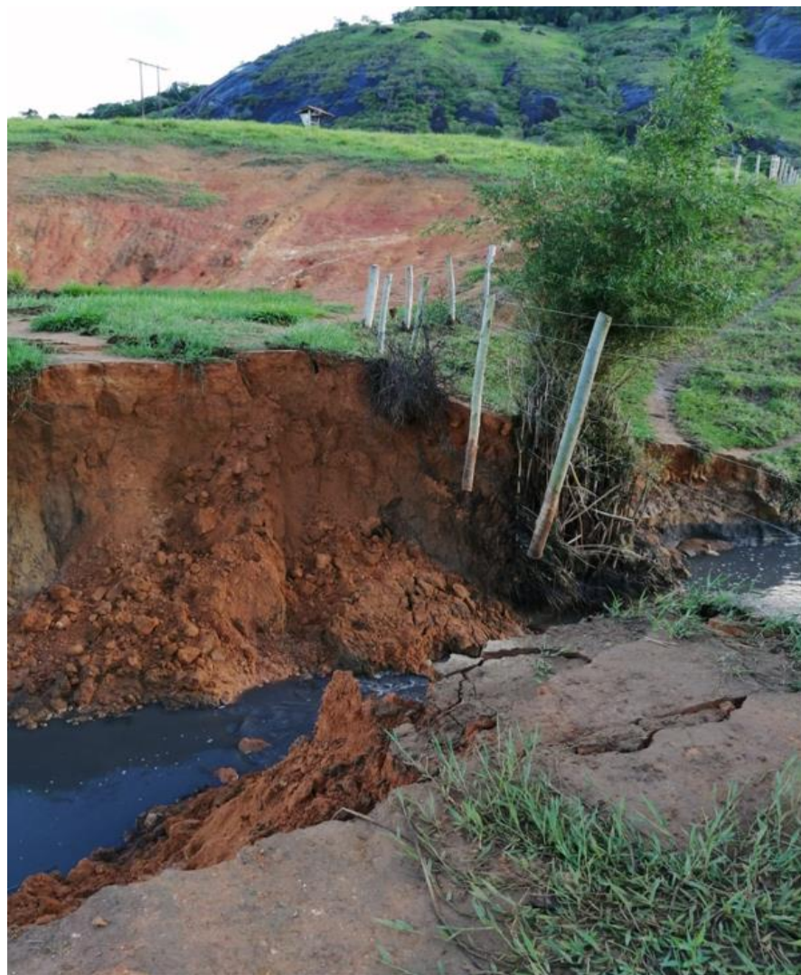
1. Rompimento por galgamento.
