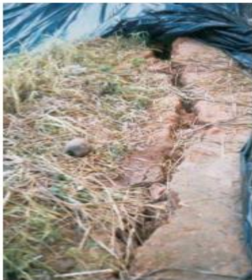
FENDA de RUPTURA UR-10, Recife
